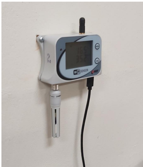
Obrázek 14 Nově instalovaný dataloger systému Comet sloužícího k monitoringu mikroklimatických podmínek v depozitářích.
